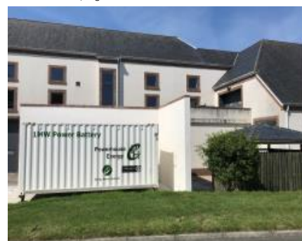
【アイルランド島に設置した同社の蓄電池システム】
