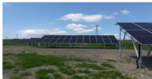
【開発中の低圧発電所】
