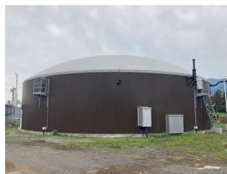
【バイオマス発電施設】
