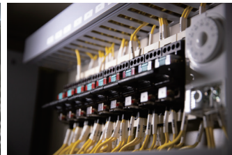
各種制御盤の設計・製作
