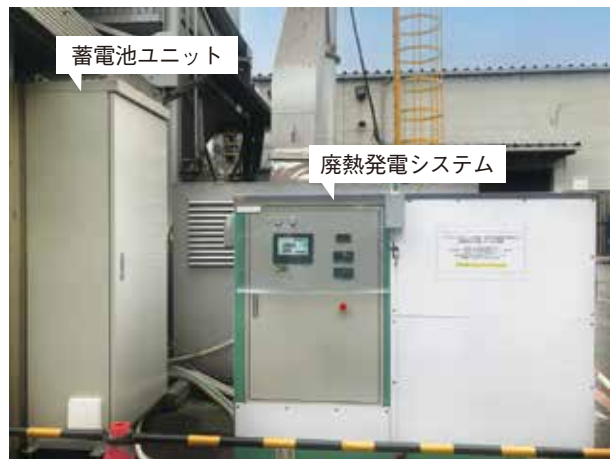
実証実験中の廃熱発電システムと蓄電池ユニット
