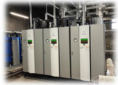
添付⑥：蒸気ボイラー 当社より提供
