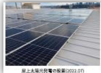
屋上太陽光発電の設置(2022.07)
